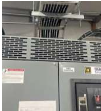
FIGURA 5. Tablero I-LINE SQUARE D, EN CADA SUBESTACION.
